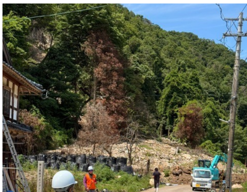
復旧が遅れている崖崩れの状況（輪島市町野町）
